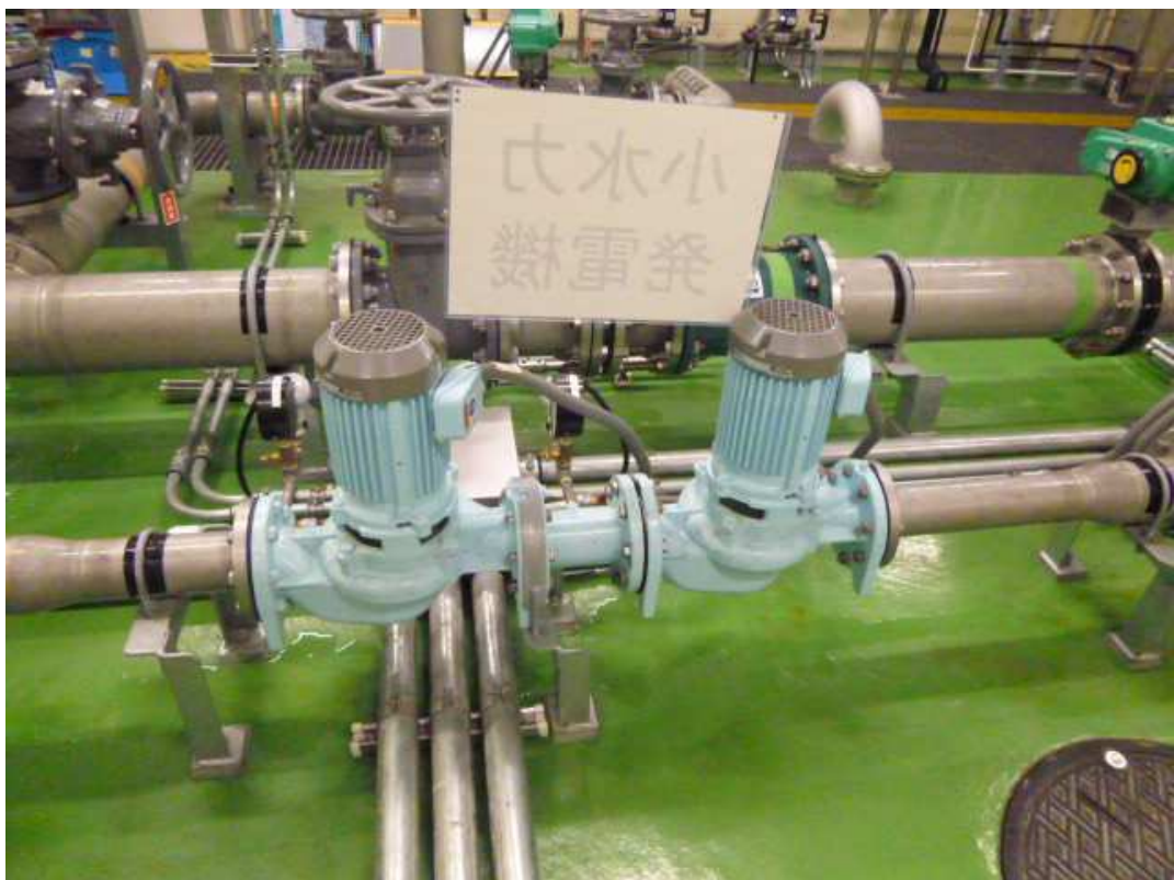
小水力発電設備
