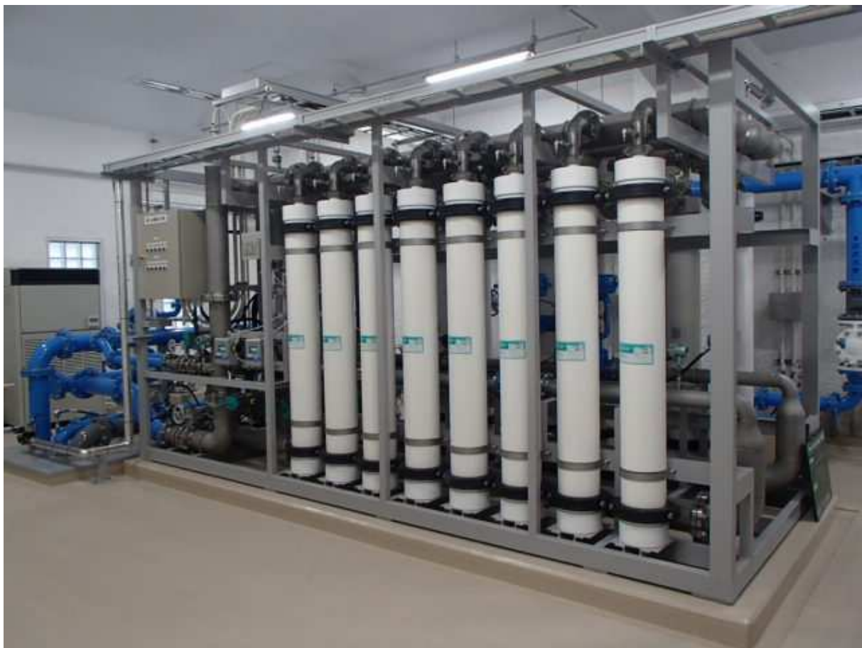
膜ろ過ユニット
